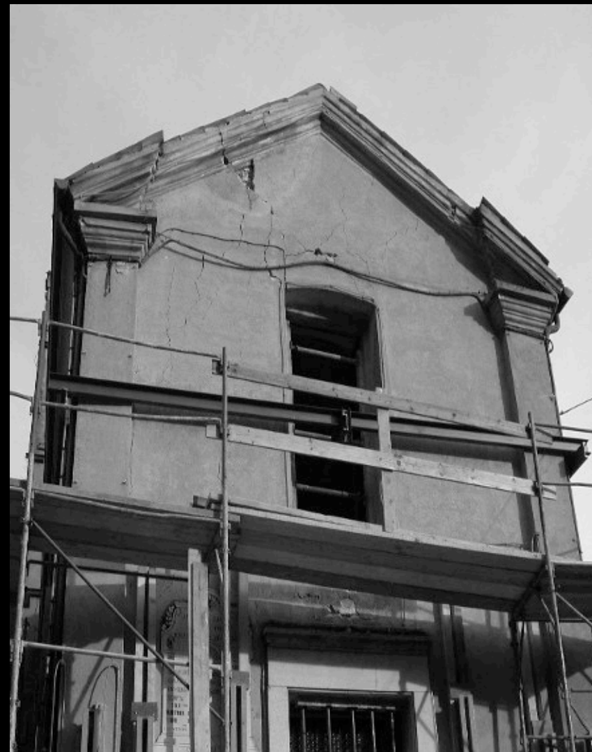
CHIESA DI S. BENEDETTO DA NORCIA A VOBARNO (LOCALITA' POMPEGNINO) INTERVENTO DI MESSA IN SICUREZZA DEL MIBAC
